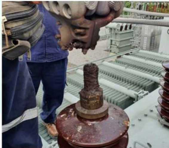
شکل ۱: خطای کانکتور بدلیل نصب ضعیف و نادرست
